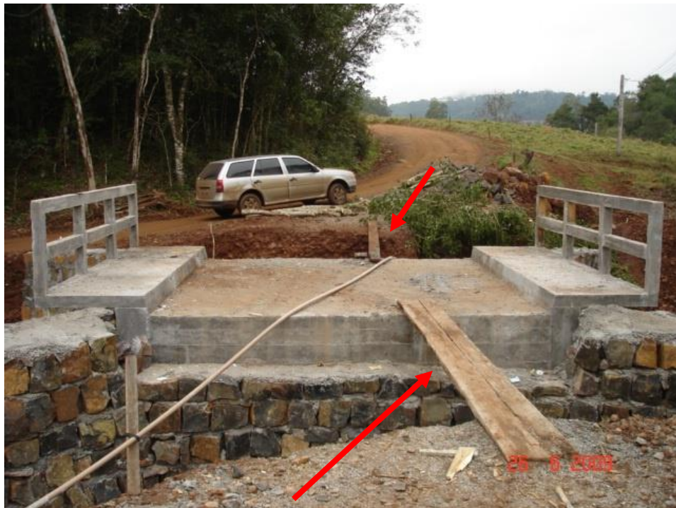
Obra apresentada como concluída – sem acessibilidade
