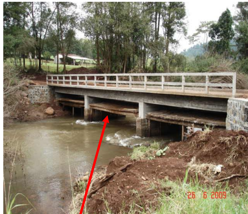
Escoramento não retirado
